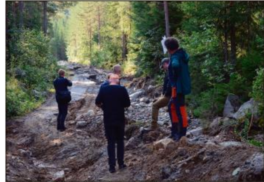
Landbruksdirektoratet og statsforvalteren var fredag på utforsking Torpo. Stort delar av skogveggen til grunnveggen Botolv Bråttan er borte etter vinterværet.
